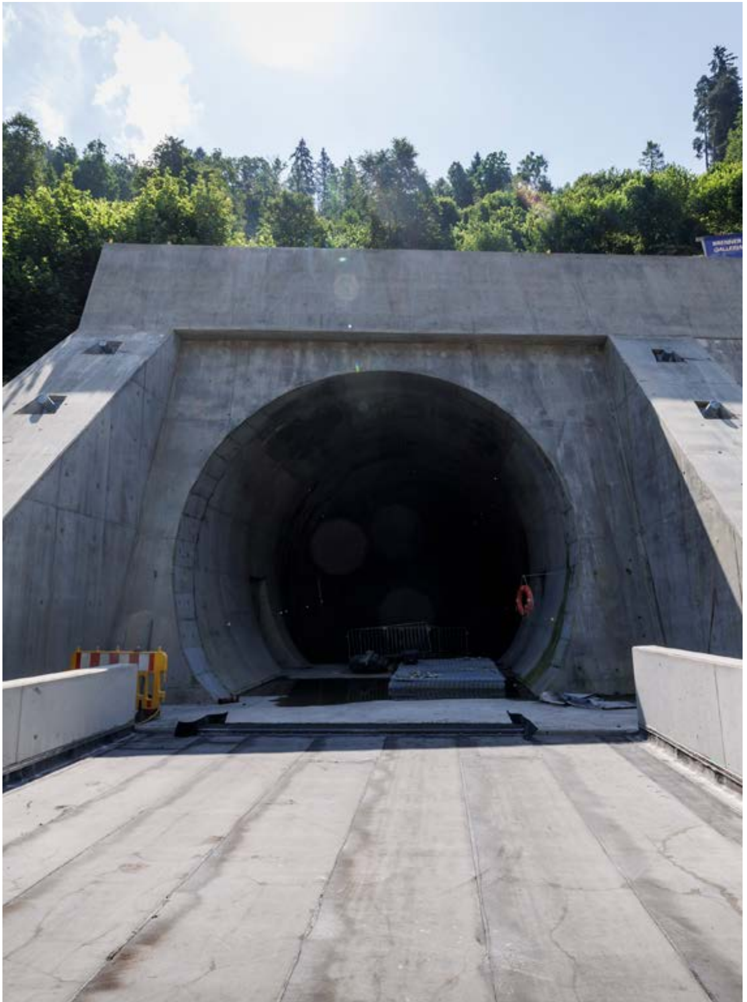
Stück für Stück entsteht das Nordportal des Brenner Basistunnels, Oktober 2023 Pezzo dopo pezzo si costruisce il portale nord della Galleria di Base del Brennero, ottobre 2023
